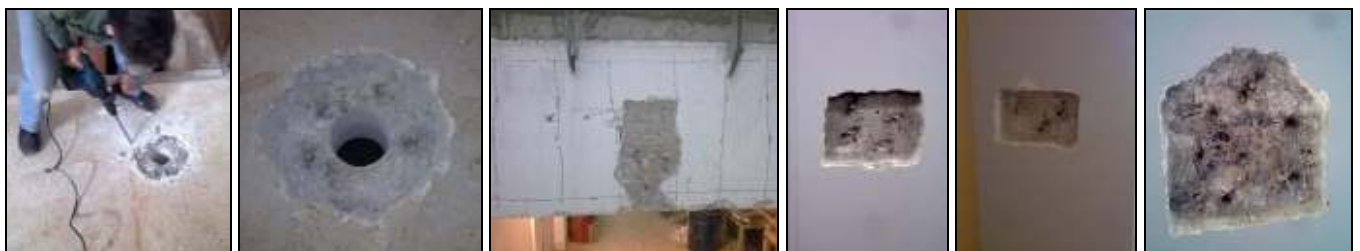
Εικόνα 30 (α) Αποκάλυψη σκυροδέματος γύρω από πυρήνα Π2, (β) Θέσεις ήλων γύρω από πυρήνα Π2, (γ), (δ), (ε), (στ) Θέσεις ήλων επί της Δ2 και των υποστρωμάτων Σ19, Σ49 και Σ41
