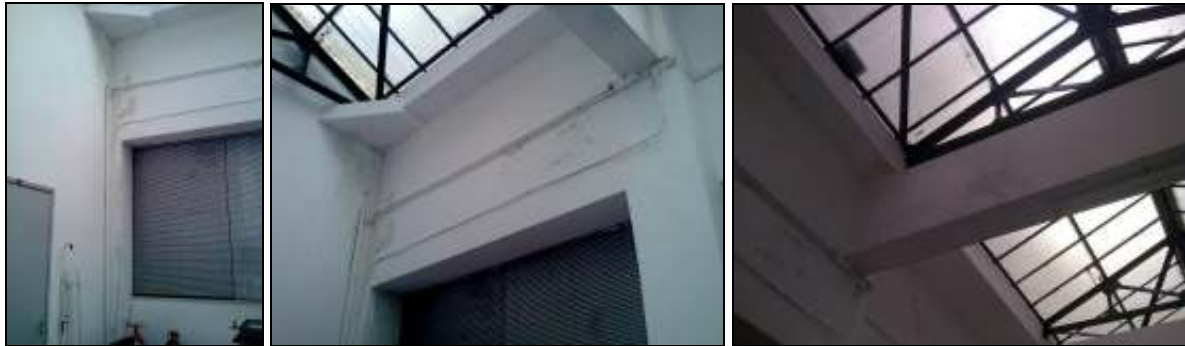
Εικόνα 5 Τοπικά προβλήματα υγρασίας στην οροφή του Κτηρίου Γραφείων (ισόγειο)
