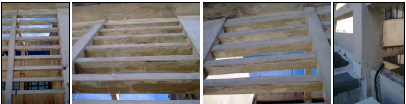
Εικόνα 6 Τοπικά προβλήματα υγρασίας, αποκαλύψεις οπλισμών και αστοχίες επικάλυψης αρχιτεκτονικών δοκών δώματος
