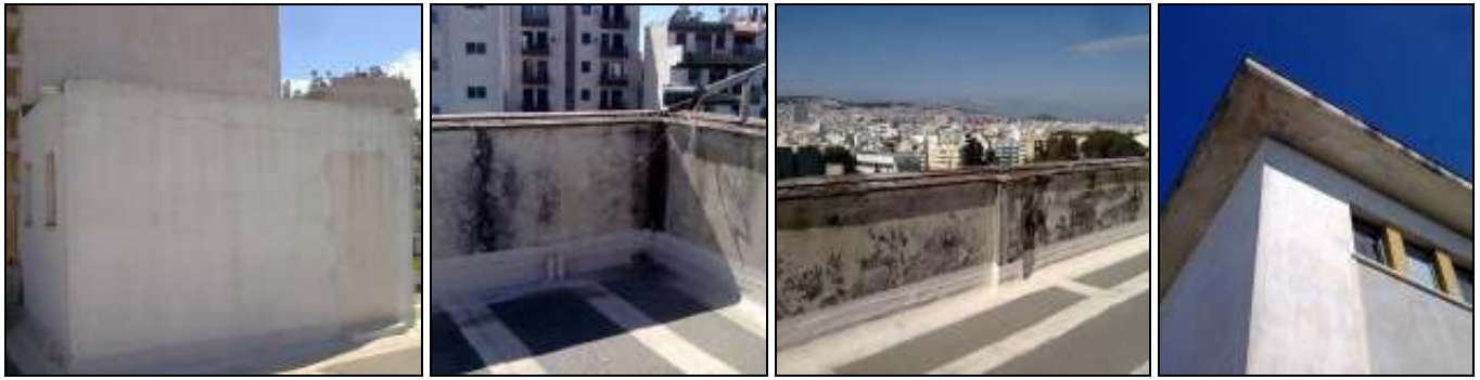
Εικόνα 7 Ρηγματώση τοιχοποιίας και προβλήματα ανθεκτικότητας σκυροδέματος στα περιμετρικά στηθαία και τη στέγη
