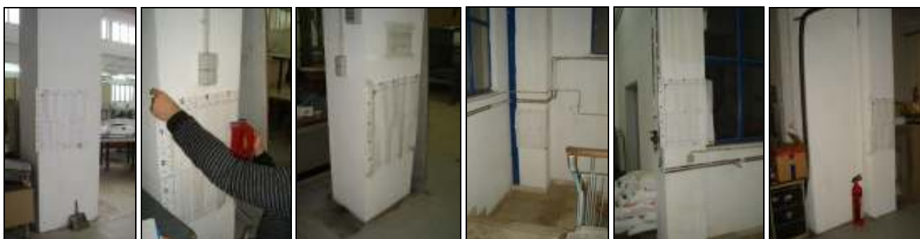
Εικόνα 14 Σαρώσεις σε πρότυπο κάναβο 60x60cm (α) Υποστύλωμα K22 (μεγάλη πλευρά), (β) Υποστύλωμα K17 (μικρή πλευρά), (γ) Υποστύλωμα K719, (δ) Υποστύλωμα Σ51, (ε) Υποστύλωμα Σ53 (Σ53)
