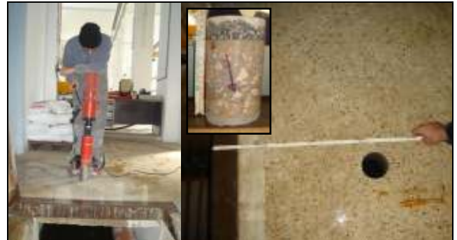
Εικόνα 9 Θέση πυρηνοληψίας πυρήνα Π2, εμπρός από το Αντλιοστάσιο και δίπλα από την καταπακτή πρόσβασης στην υπόγεια δεξαμενή
