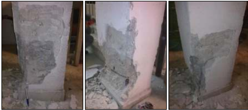
Εικόνα 4 Διάβρωση οπλισμού στο υποστήλωμα K715
