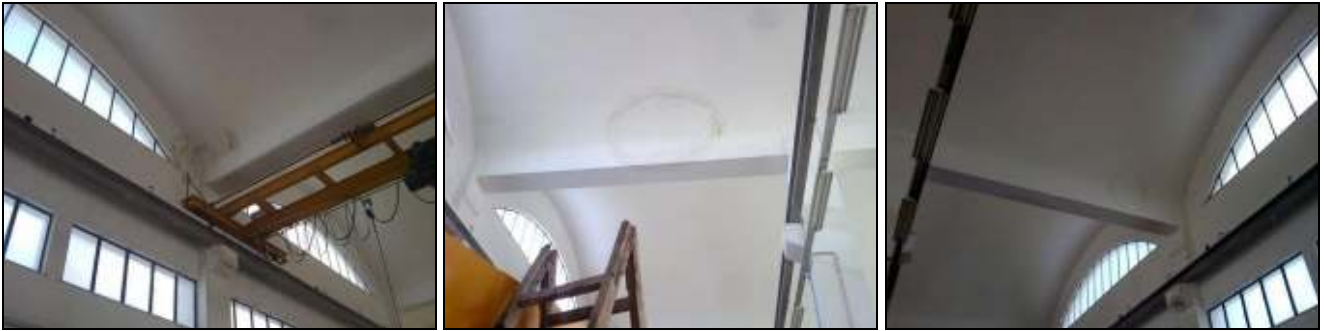
Εικόνα 2 Τοπικά προβλήματα υγρασίας στην οροφή του Κτηρίου Εργαστηρίου (ισόγειο)
