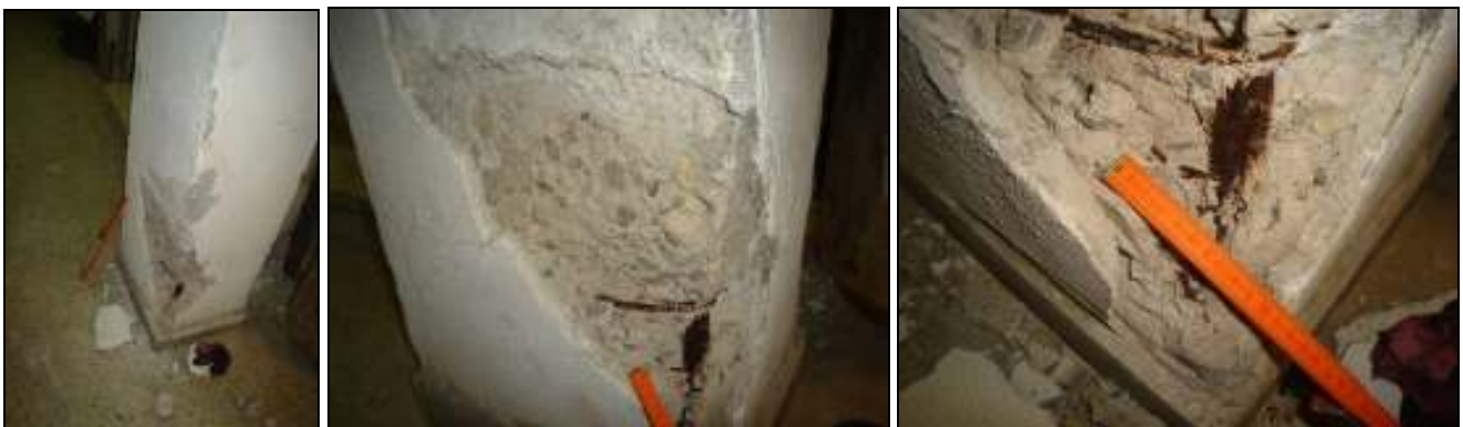
Εικόνα 3 Διάβρωση οπλισμού και αποσάθρωση της επικάλυψης στο υποστυλώμα K714 (αρχική κατάσταση και μετά από την περαιτέρω αποκάλυψη με μηχανικά μέσα)
