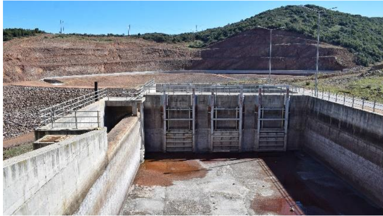
Εικόνα 2.19: Τα θυροφράγματα επικοινωνίας μεταξύ των θαλάμων και ο θάλαμος φόρτισης στο αριστερό τοίχωμα (Πηγή: Προσωπικό αρχείο, 13.03.2020)
