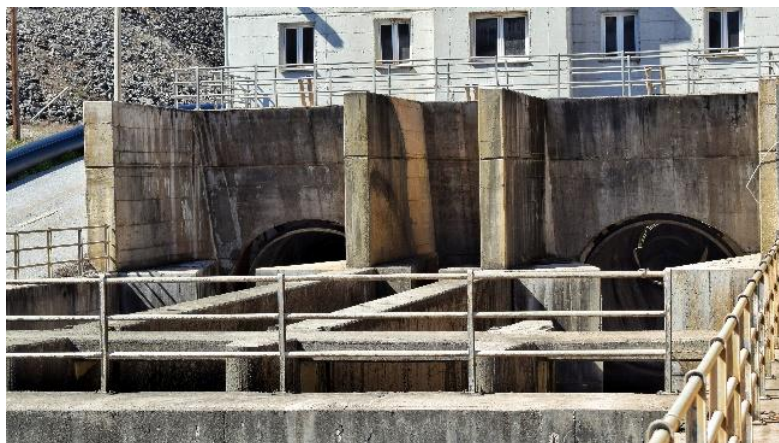
Εικόνα 2.18: Οι βαλβίδες καταστροφής ενέργειας (Πηγή: Προσωπικό αρχείο, 13.03.2020)
