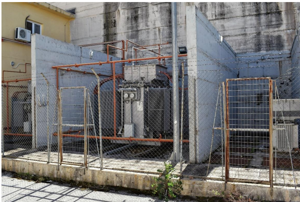
Εικόνα Α.3: Οι μετασχηματιστές για τις μονάδες του Σμόκοβο-1. (Πηγή: Προσωπικό Αρχείο, 13.03.2020)
