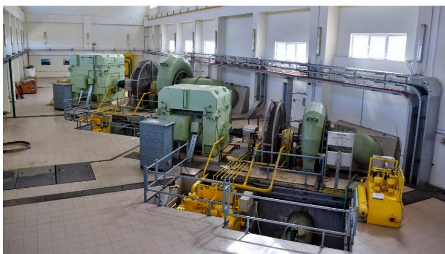
Εικόνα 2.22: Διακρίνονται οι Μονάδες 1 (μπροστά) και 2 (πίσω) του Σταθμού (Πηγή: Προσωπικό αρχείο, 13.03.2020)
