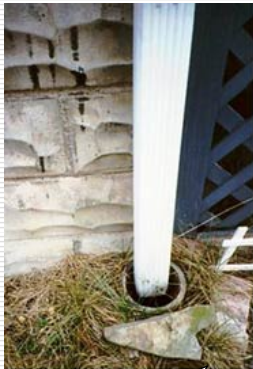
Παράνομη σύνδεση υδρορροής στο δίκτυο ακαθάρτων
