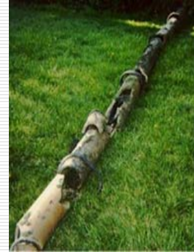
Διαβρωμένος αγωγός αποχέτευσης
