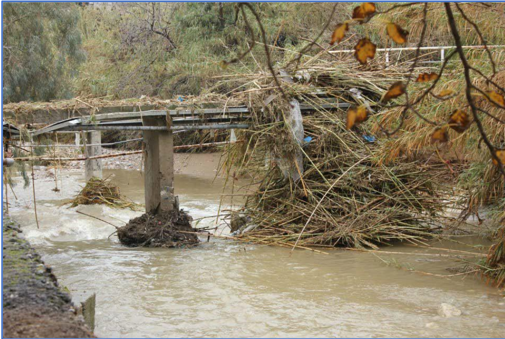
Σχήμα 2.8: Η πεζογέφυρα Κορούζη μετά την υπερχειλίση ( www.notia.gr ).
