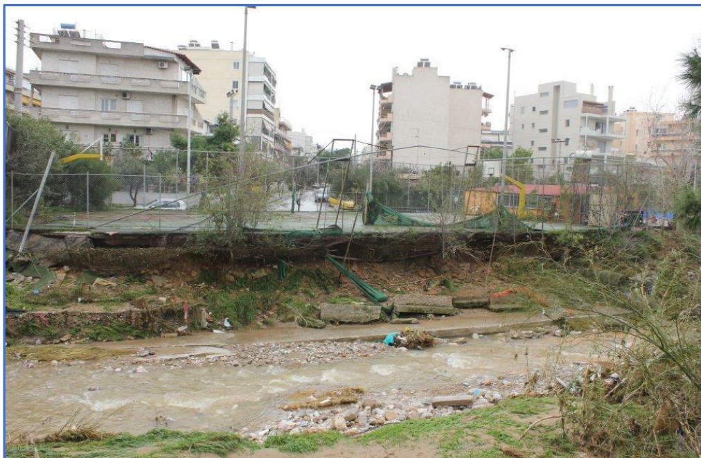
Σχήμα 2.9: Καθίζηση γηπέδου μπάσκετ, μετά το πλημμυρικό επεισόδιο ( www.notia.gr ).
