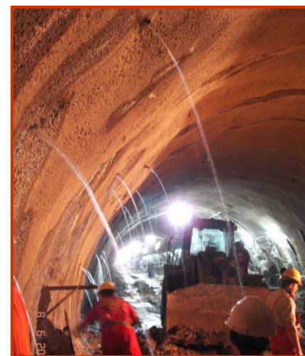
Εισροή νερού από διατρήματα στην παρειά της σήραγγας στην παλαιά κοίτη
