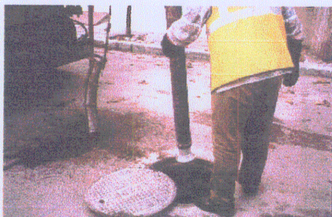
Φωτογραφία 6.3 : Εισαγωγή σωλήνα αναρρόφησης
