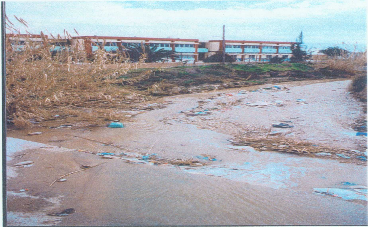
Φωτο 7-28: Σχολικό συγκρότημα με σοβαρές ζημιές δίπλα από το ρέμα της Κατερινέζας στο Καματερό.
