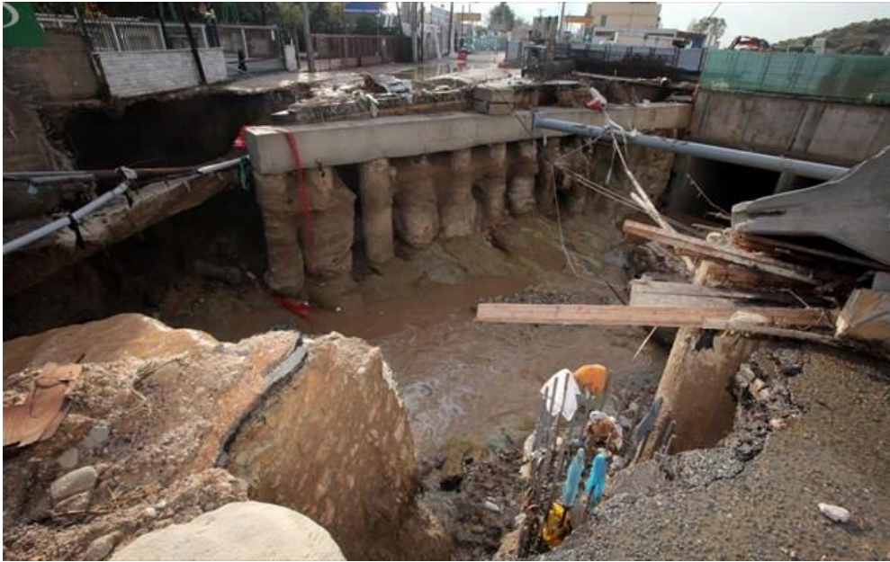
Σχήμα 4.6: Καθίζηση στη οδόστρωμα της λεωφόρου Φυλής στο Καματερό η οποία προκλήθηκε από ισχυρή καταιγίδα στις 11/11/2013 (Πηγή: www.naftemporiki.gr , 2013)
