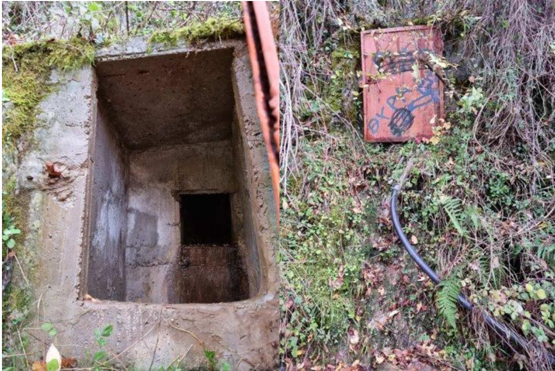
Δεξαμενή στο δρόμο προς Μουζιά, που τροφοδοτεί τη Σαϊδόνα
