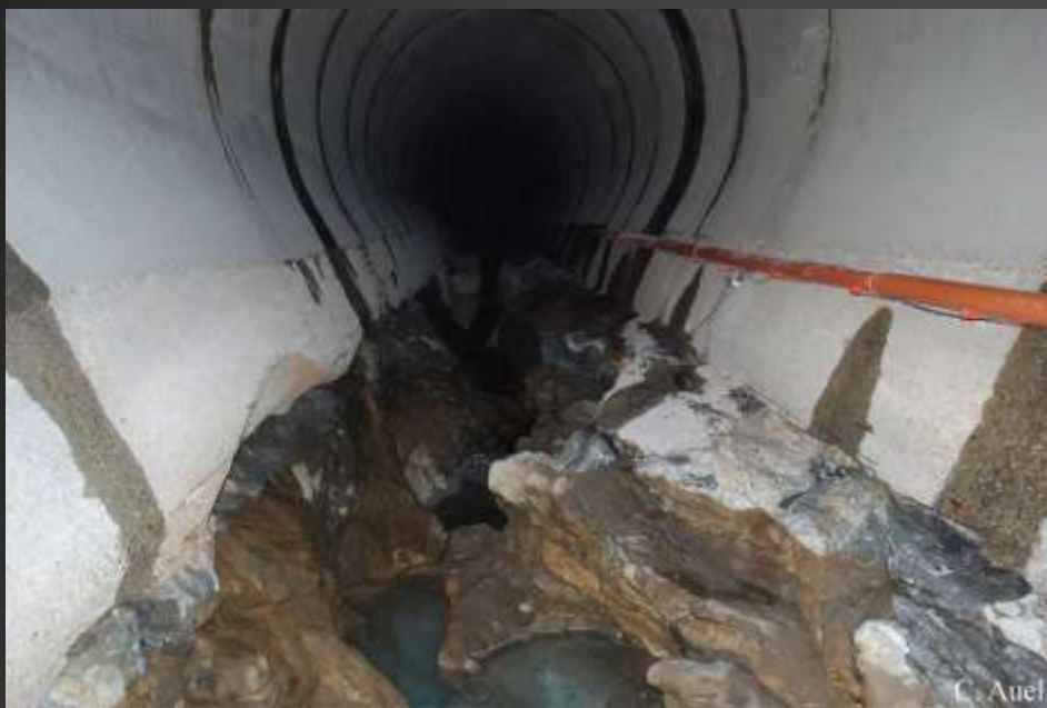
Σήραγγα φράγματος Palagnedra, Ticino canton, Ελβετία. Εικονοζόμενο είναι διαβρωμένο κανάλι βάθους ~2 μέτρων
