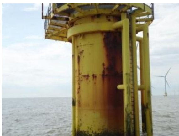
Εικόνα 3: Φαινόμενο διάβρωσης σε υπεράκτια ανεμογεννήτρια (Πηγή: Abfad )
