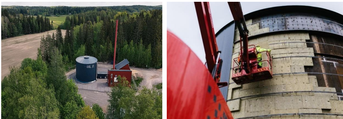
Σχήμα 4.2 Αριστερά: Εναέρια λήψη εγκατάστασης Sand Battery ισχύος 1 MW στο Pornainen της Φινλανδίας, Δεξιά: περίβλημα πολλαπλών στρωμάτων μονωτικών υλικών γύρω από το σιλό για βέλτιστη μόνωση [116].
