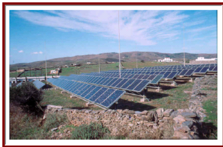
Εικόνα 2.8: εγκατεστημένο φωτοβολταϊκό πάρκο της ΔΕΗ 100 KWp στην Κύθνο πηγή http://www.dei.gr
